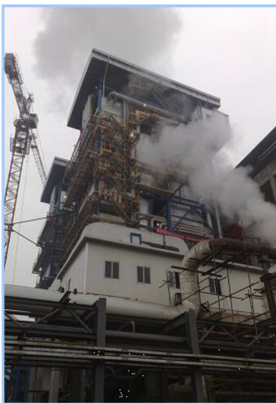
东方希望重庆水泥有限公司 1 × 150t/h-9.8 CFB 锅炉 (2009-09-05签订)
